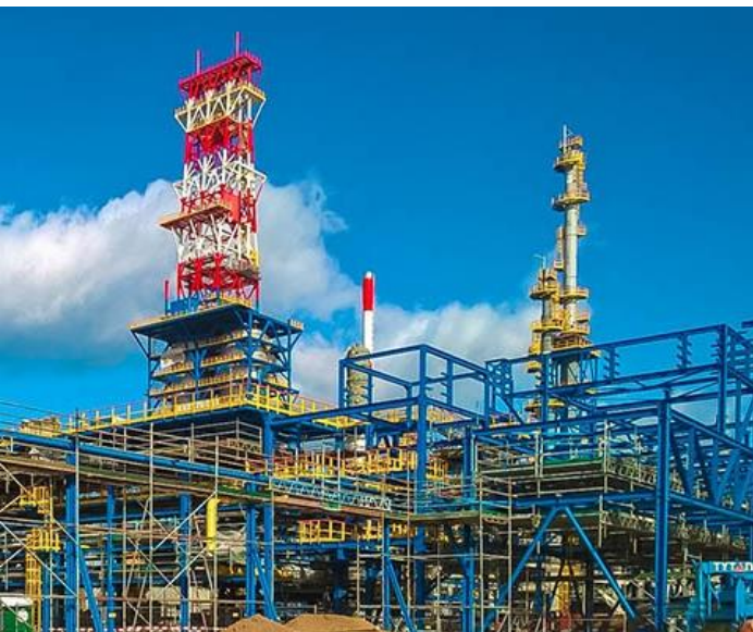
Elektrownie, przemysł petrochemiczny
