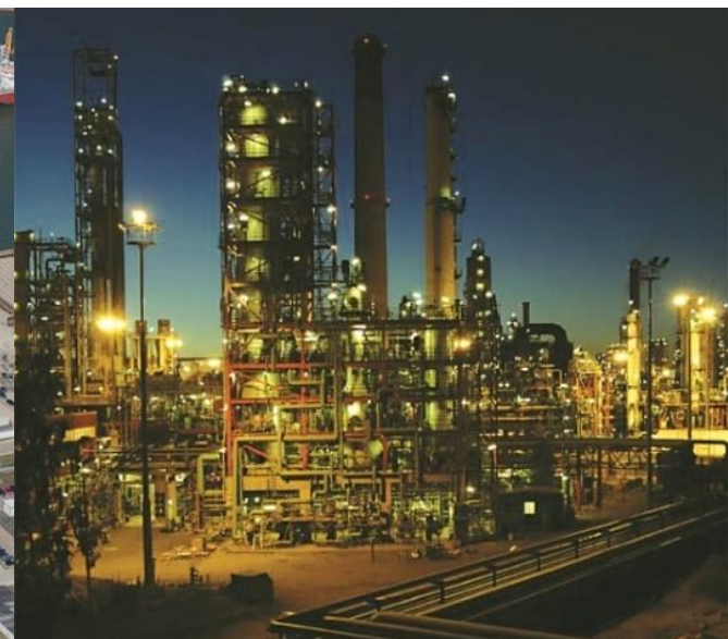
Instalacja Biodiesel dla Porvoo, FINLAND
